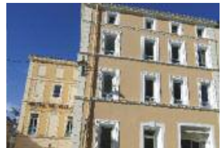
Depuis fin juin les services techniques, environnement et urbanisme ont réintégré les locaux remis à neuf, 77 Route Nationale 7.
